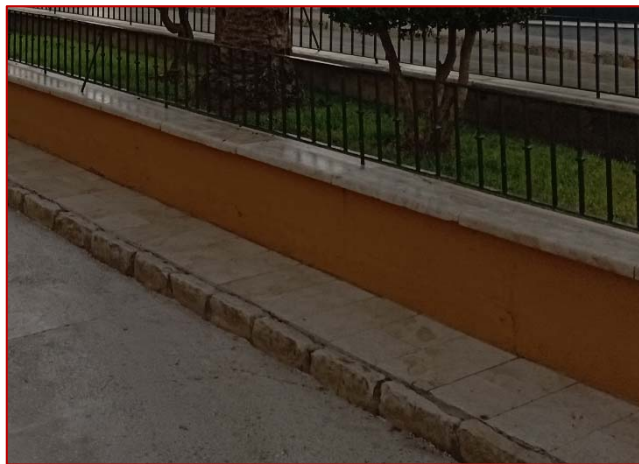
Ilustración 1. Murete jardinera actual en c/San José.
